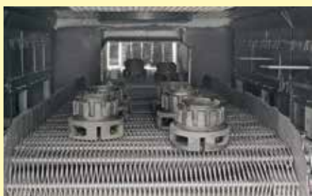
Привод секционного конвейера в проходной печи
