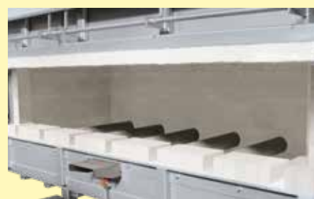
Непрямой газовый обогрев с помощью труб радиационного нагрева
