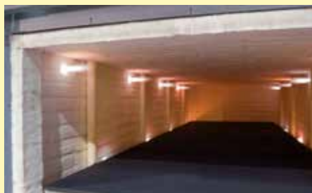
Внутреннее пространство печи с восемью горелками сверхбыстрого сжигания
