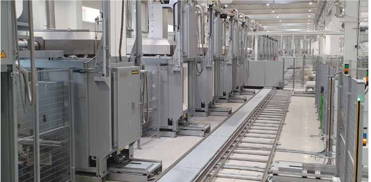
Ofenanlage mit sechs Kombi-Herdwagenöfen W 2254/14 DB200-3 mit katalytischer Nachverbrennung für alternierenden Betrieb, Hubtür und Transfersystem mit Be-/Entladestation für den automatischen Betrieb
