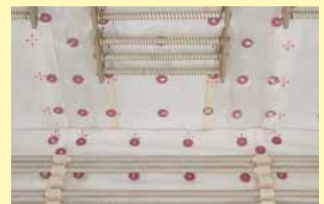
Gewebetuchabdeckung der Faserdecke (und Seiten) zur Reduzierung von Faserstäuben
