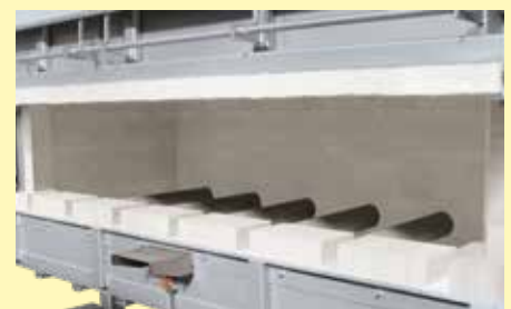
Indirekte Heizung mit Strahlrohren
