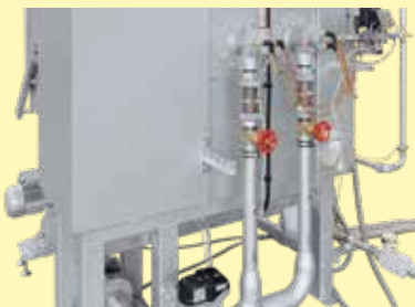
Gastrecke mit zwei Brennern in der Ofenrückwand
